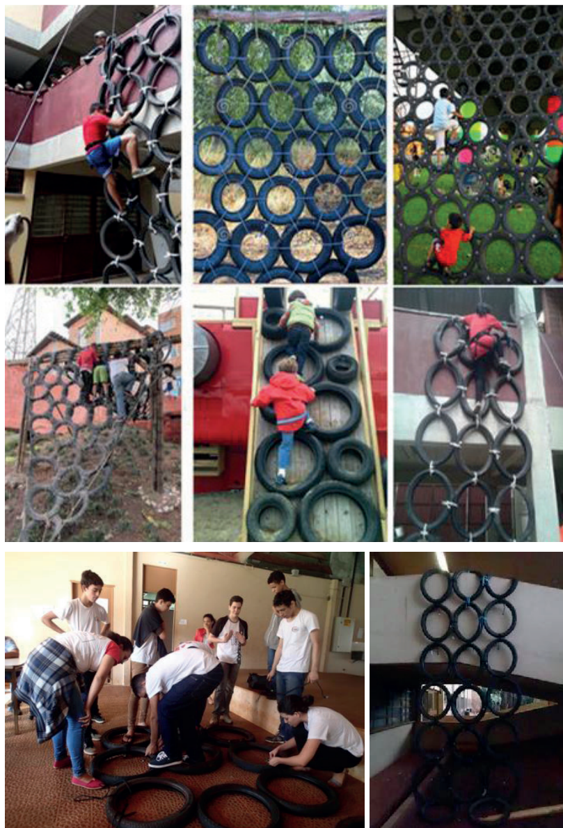
Figura 2 – Modelo e processo de construção da parede de escalada de pneus realizada na 6ª e 7ª aulas
